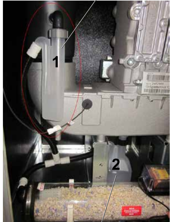
Siphon an Kondensatwanne
