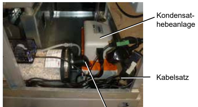
Anschluss Kondensathepumpe an Neutralisation
