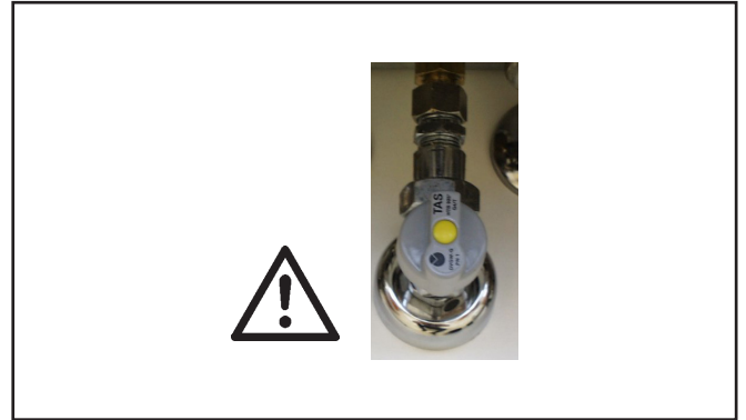
Bild: Gasanschluß: Gefahr von Vergiftung und Explosionsgefahr durch auströmendes Gas
